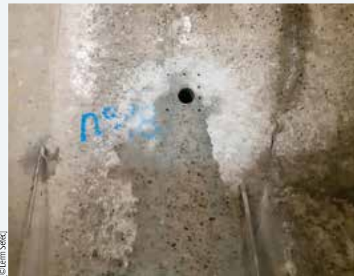
Béton de revêtement d'un tunnel soumis à une agression par les sulfates transportés via une fissure de retrait.
