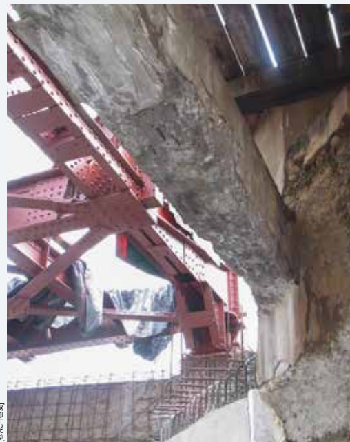
Les bétons d'ouvrages ayant subi une altération par RSE peuvent être réparés de façon traditionnelle par purge des parties dégradées et polluées.
