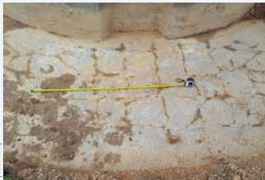
Semelle de pile de pont affectée par une réaction de gonflement interne due à la formation d'ettringite différée (RSI).
